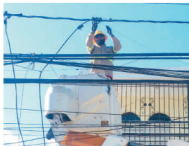
↑ Técnico de la empresa Edesur Dominicana realiza trabajos durante el operativo antifraude.
